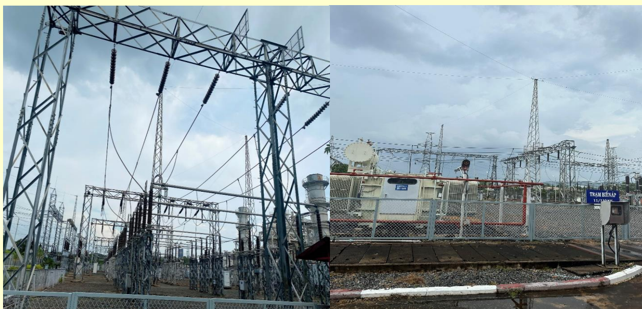
Hệ thống trạm máy biến áp tại nhà máy nhiệt điện Phú Mỹ!
